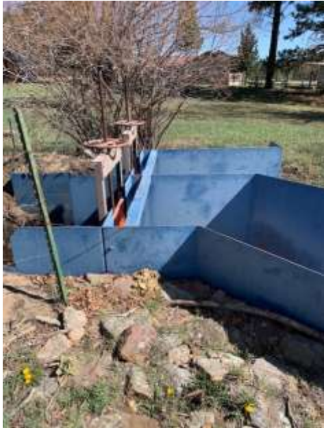
LeDoux Steel Diversion for Acequias De la Aguila and Otra Banda. Harold Trujillo Photo 2021
